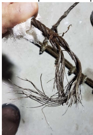
Figura 13 - Ponto em que houve a ruptura do cabo.
