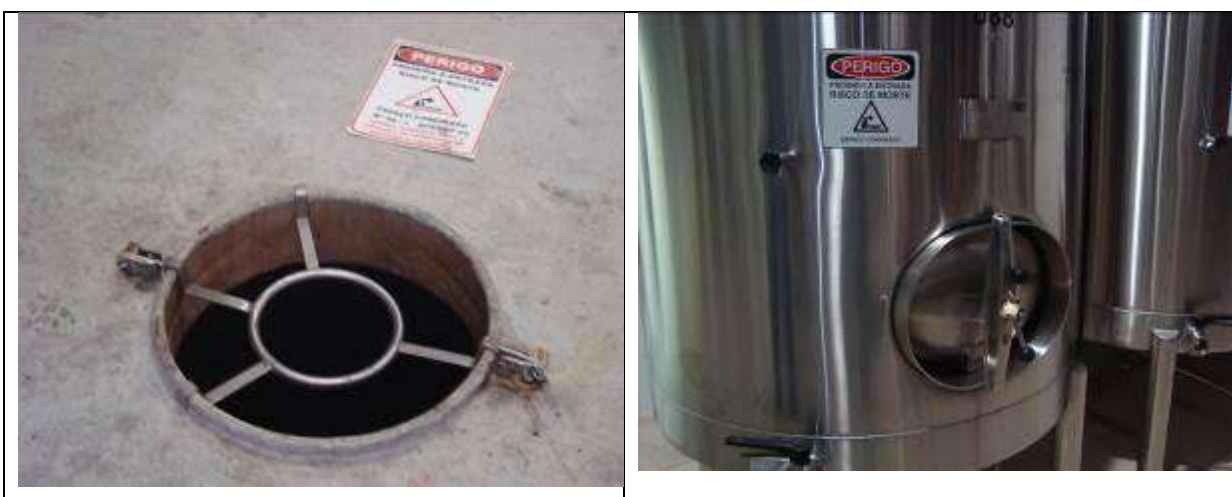
Figuras 13 e 14 – Bloqueio e sinalização dos acessos aos espaços confinados
